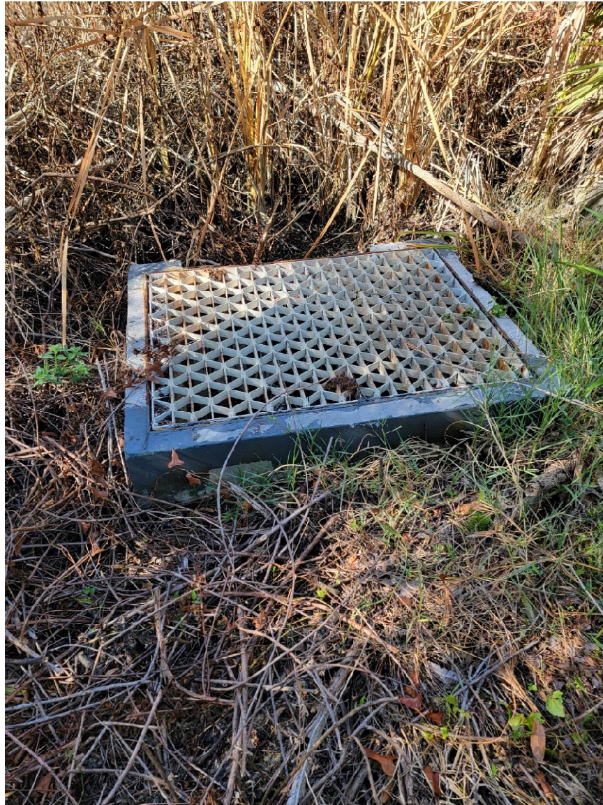
Control Structure - CS-W-L
